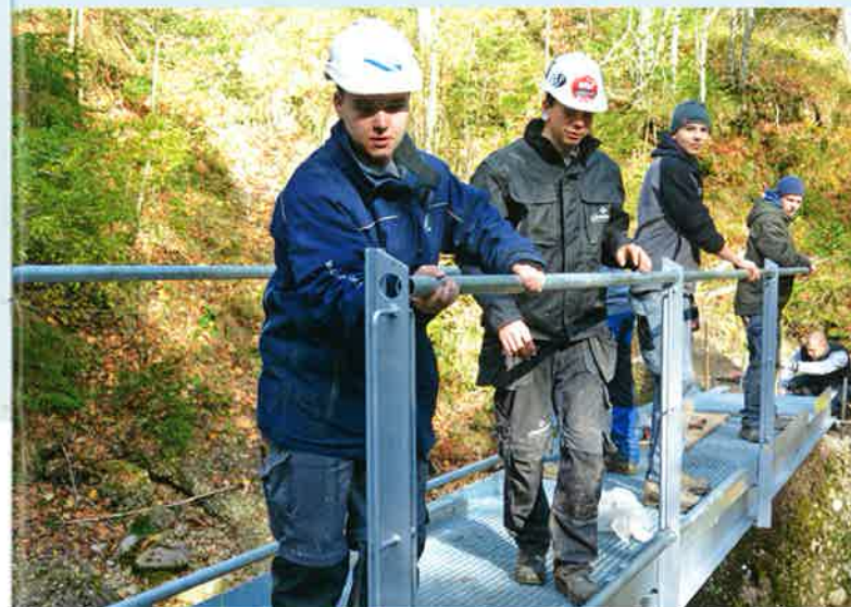
Die Brücke liegt auf und ist befestigt. Jetzt werden die Geländerrohre eingeführt. Le pont est posé et fixé. Les apprentis mettent en place les tubes de la balustrade.
